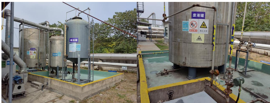
图 4.1-2 焚烧锅炉间储罐区
